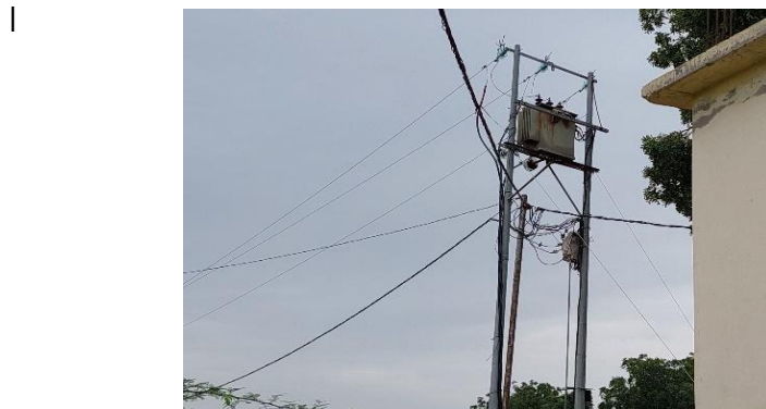
Figure 3 : Ligne électrique MT/BT à renforcer
