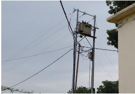
Figure 4: Ligne électrique MT/BT à renforcer source : photo prise sur le terrain le 05/10/2022
